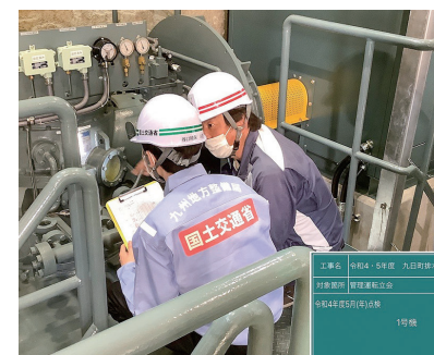
排水機場の定期点検
