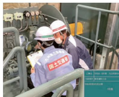
排水機場の定期点検
