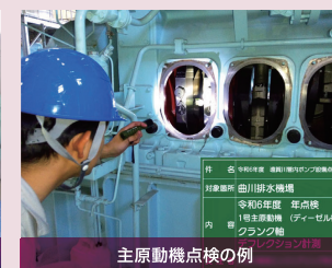
主原動機点検の例
