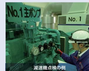
減速機点検の例
