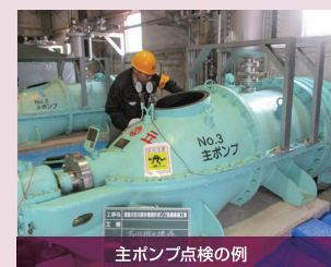
主ポンプ点検の例
