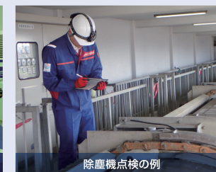
除塵機点検の例
