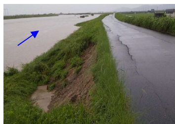
堤防の法崩れの様子
