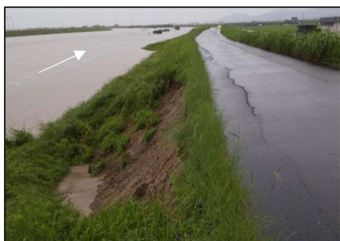
写真 1.2.1 堤防の法崩れの様子
