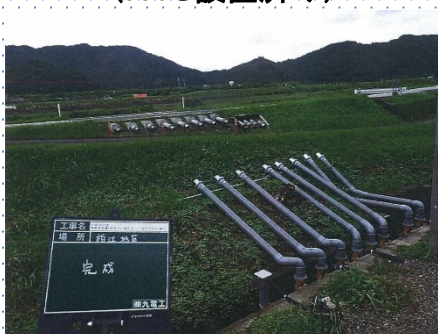
柏江地区(佐伯市大字長良)の 排水ポンプ設置状況
