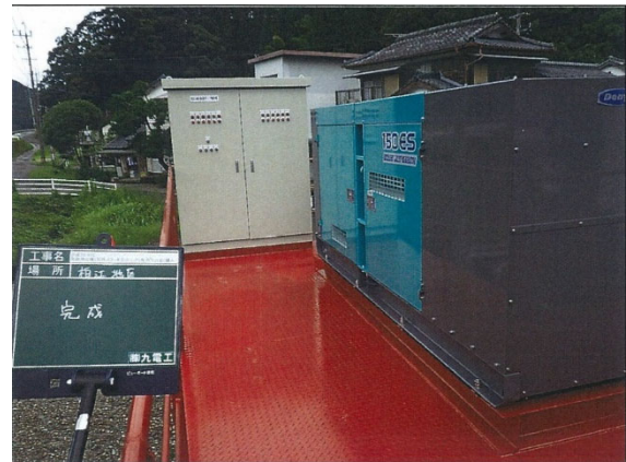
発動発電機常設例(柏江地区)
