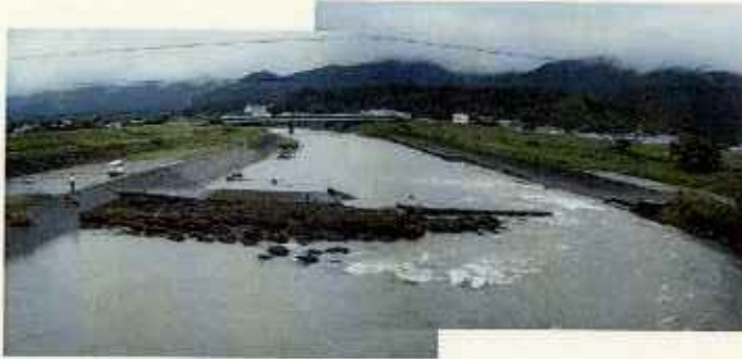
加久藤橋より倒壊した床固を見た写真（7月7日）
