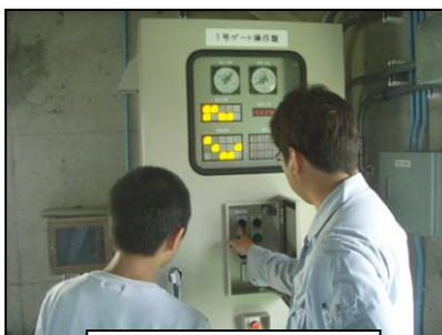
真幸堰操作盤
