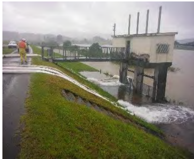
＜国＞緊急内水対策車排水状況
