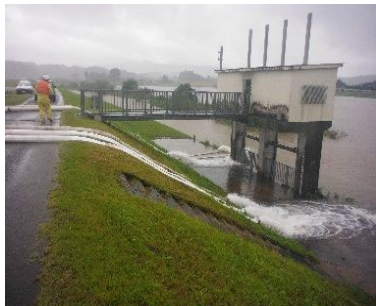
＜＜国＞＞緊急内水対策車排水状況
