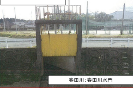
ゲートの腐食
