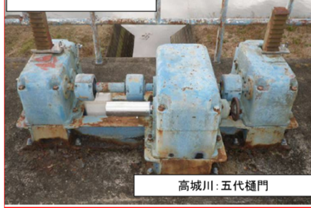
開閉器腐食損傷
