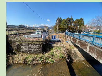
自動転倒ゲートの活用 (えびの市)
