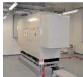
非常用発電設備のイメージ
