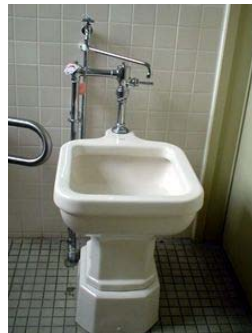
大口市地域防災計画に記載され、福祉避難所に設置されたオストメイト対応トイレ。
