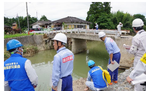
広川町の橋梁被災状況調査 (TEC-FORCE・災害復旧技術専門家)
