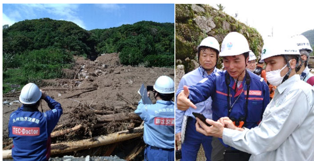
唐津市の土砂崩落における被災状況調査 (TEC-FORCE・TEC-DOCTOR)
