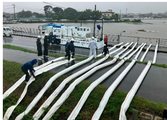
浸水箇所におけるポンプ車出動状況 (筑後川水系宝満川)
