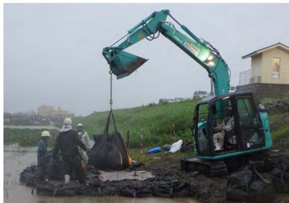
応急対策状況
