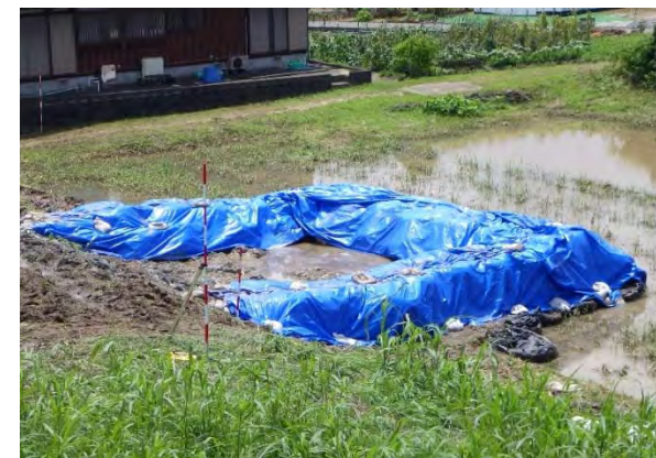
応急対策状況
