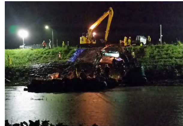
応急対策状況
