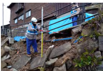
道路被災状況調査 (輪島市)
