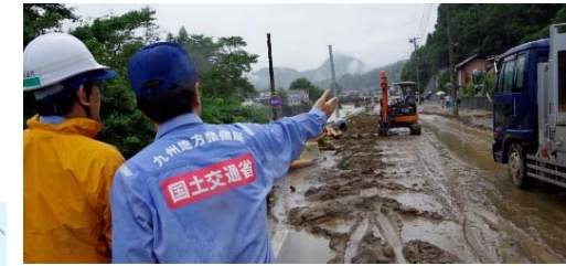
▲ 道路の被災調査
