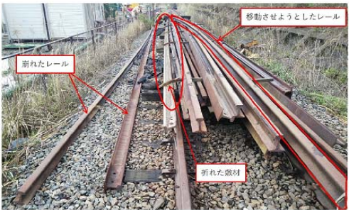
写真1 事故発生時現場状況(上流側より)
