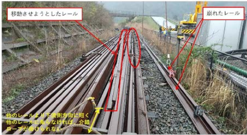
写真2 事故発生時現場状況(下流側より)
