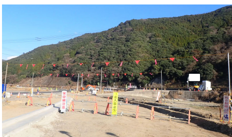
架空線前後(5m以上手前)に高さ制限バー(H=3.8m)の設置と「架空線注意」看板を設置する
