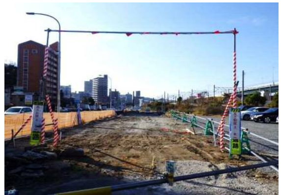
架空線等の接触・切断事故防止対策 (高さ制限装置)
