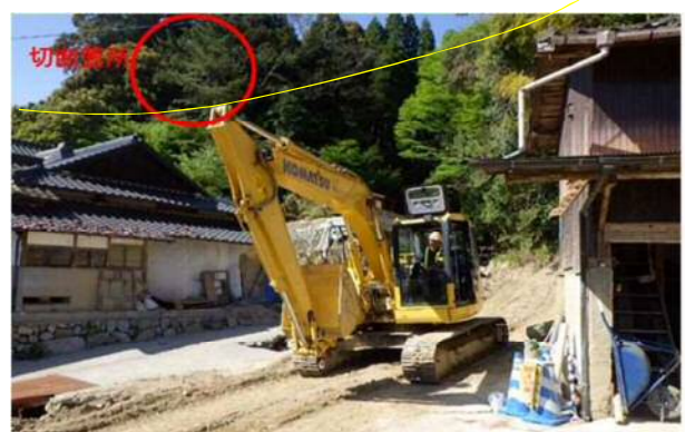
バックホウ(クレーン仕様)にて移動中にアームが電線の引込線に接触し切断
