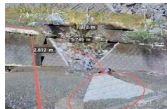
被災状況3次元モデル化の事例
