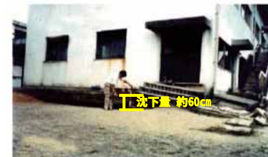
平成6年白石町での地盤沈下状況
