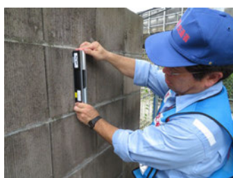
既設塀の傾きの確認
