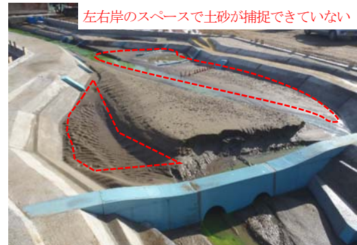
写真-7 洪水末期における土砂堆積状況
