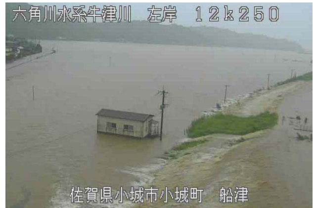
図-3 堤防からの越水状況
