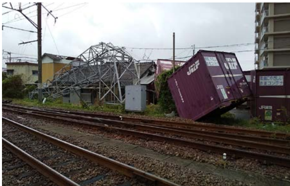
(写真-4) JR 延岡駅 コンテナ転倒・鉄塔折損
