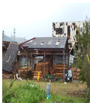
(写真-3) 施設被害
