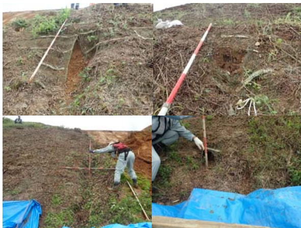
写真－4 周辺法面のガリー浸食
