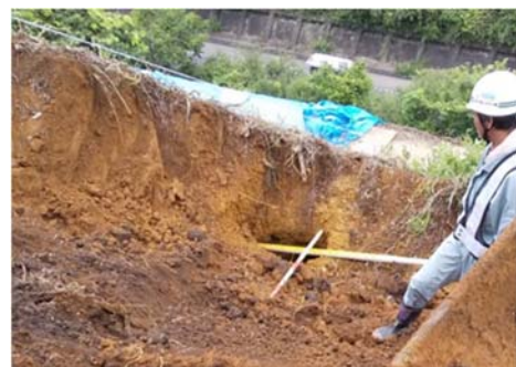
写真-3 切土中に確認された空洞
