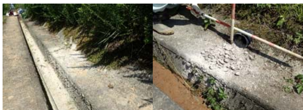
写真－5 周辺法面の湧水跡
