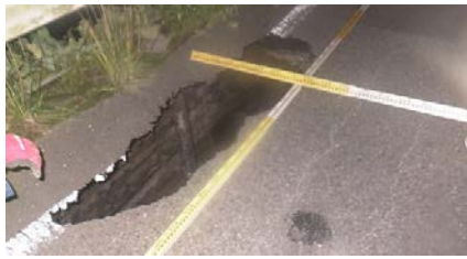
図-4 陥没箇所発見時の状況 (その後さらに陥没範囲が広いことが判明)
