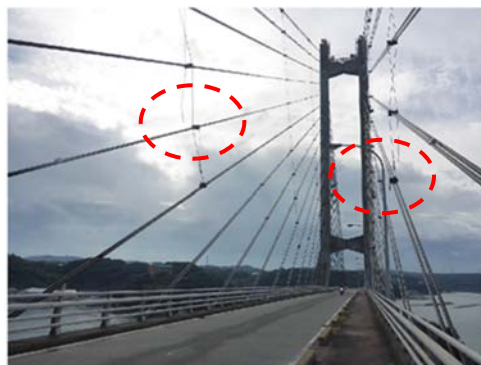
写真-2 制振ワイヤ破断状況
