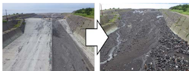
写真-1 野尻川における土石流発生前後の状況
