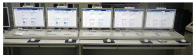
図11 新堰コンの遠方手動操作卓
