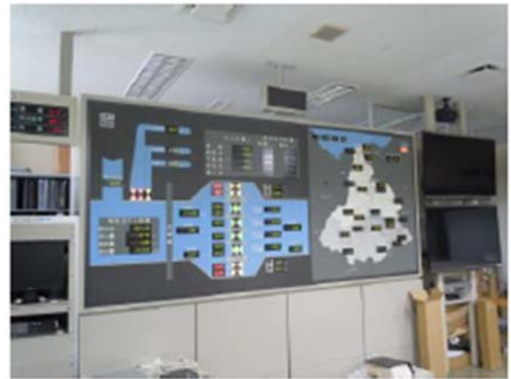
図8 旧堰コンの表示パネル
