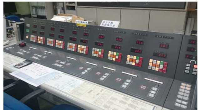
図10 旧堰コンの遠方手動操作卓
