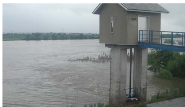
写真-1 排水機場の排水状況
