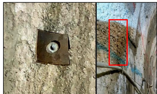
図-6 ロックボルト変形、ひび割れ状況
