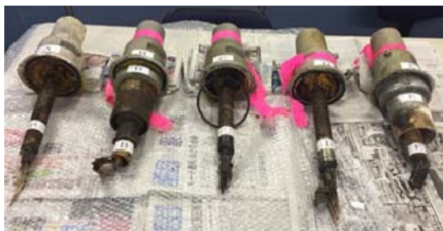
写真5 破断したアンカー (芹ヶ野地区)
