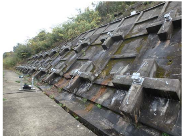
写真4 飛び抜け防止装置設置写真
