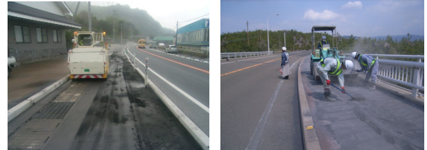
写真-6 (左) 歩道清掃 (雨で濡れた降灰) 写真-7 (右) 人力清掃 (橋梁歩道部)
