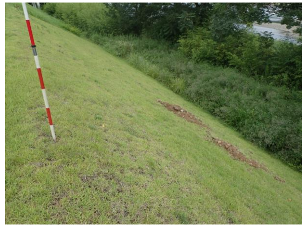
写真-2 掘り起こし被害箇所の高水敷の様子 (高島地区)
