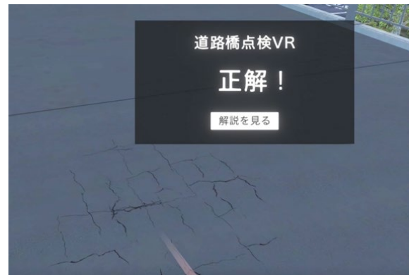
図-12 VRによる損傷の確認
