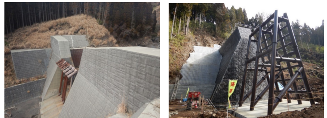
図-9 コンクリート堰堤 残存型枠事例
