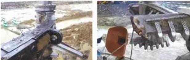
図-22 攪拌翼の破損・修理状況
