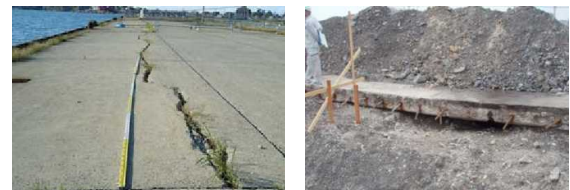
図-2 老朽化状況 (ひび割れ・陥没)
