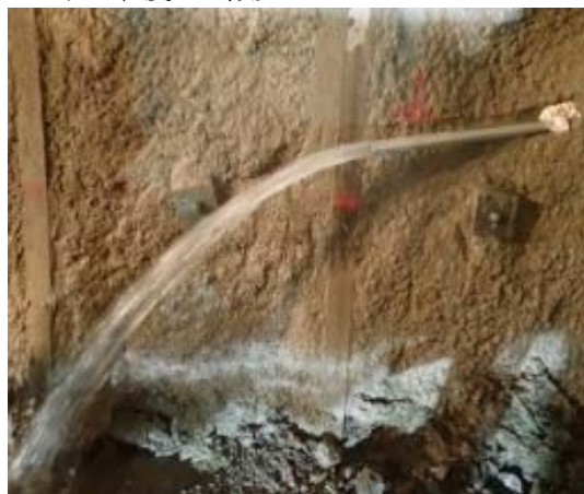
写真-6 水抜きボーリングの湧水状況
