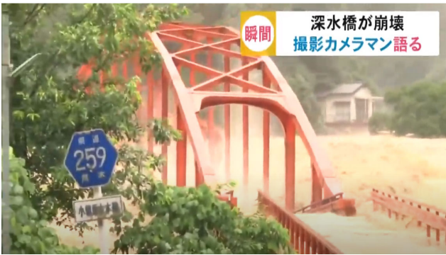
写真-6 深水橋流失状況
