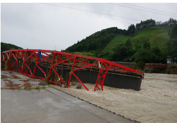
写真-4 相良橋流失状況
