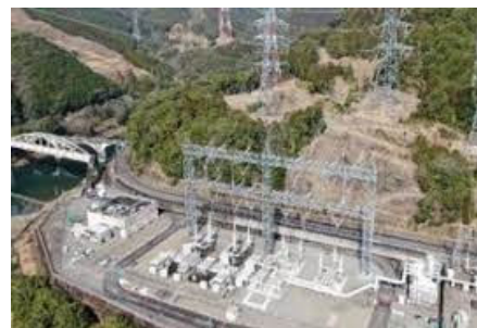
宮崎県木城町 ひむか変電所
