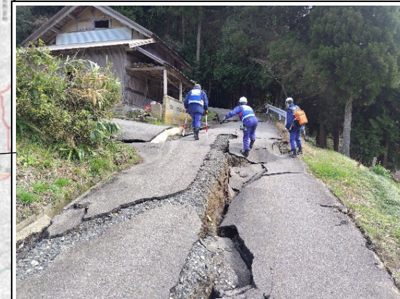
地盤振動により道路が陥没・崩壊
