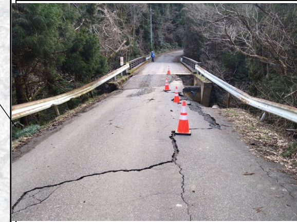
鑓川橋 取付擁壁の崩落
