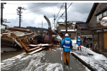
被災状況調査
