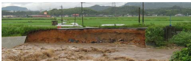
堤防護岸の崩壊状況
