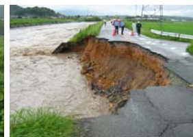
堤防護岸の崩壊状況
