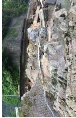
写真②：H29.7被災（路肩崩落）
