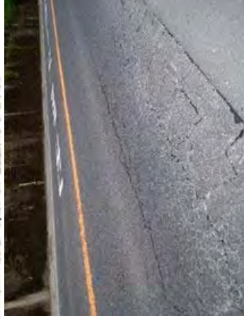
路面クラック
