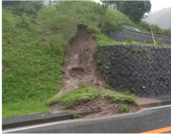
写真①：法面崩壊状況
