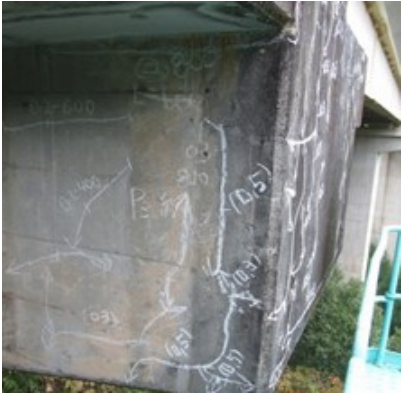
コンクリートのひびわれ
