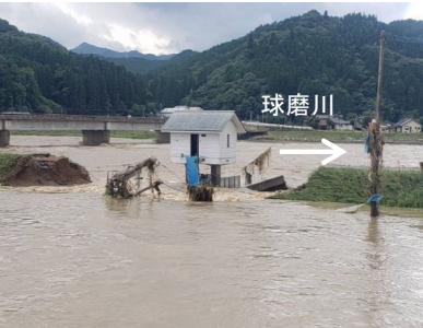
▲球磨川56.4kの堤防決壊状況(人吉市)
