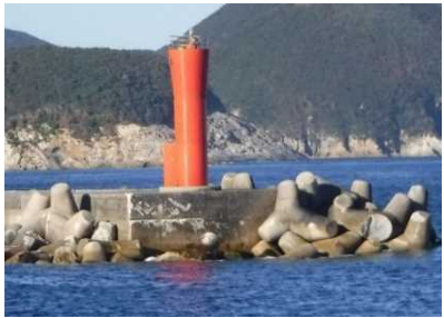
防波堤(北) 越波状況
